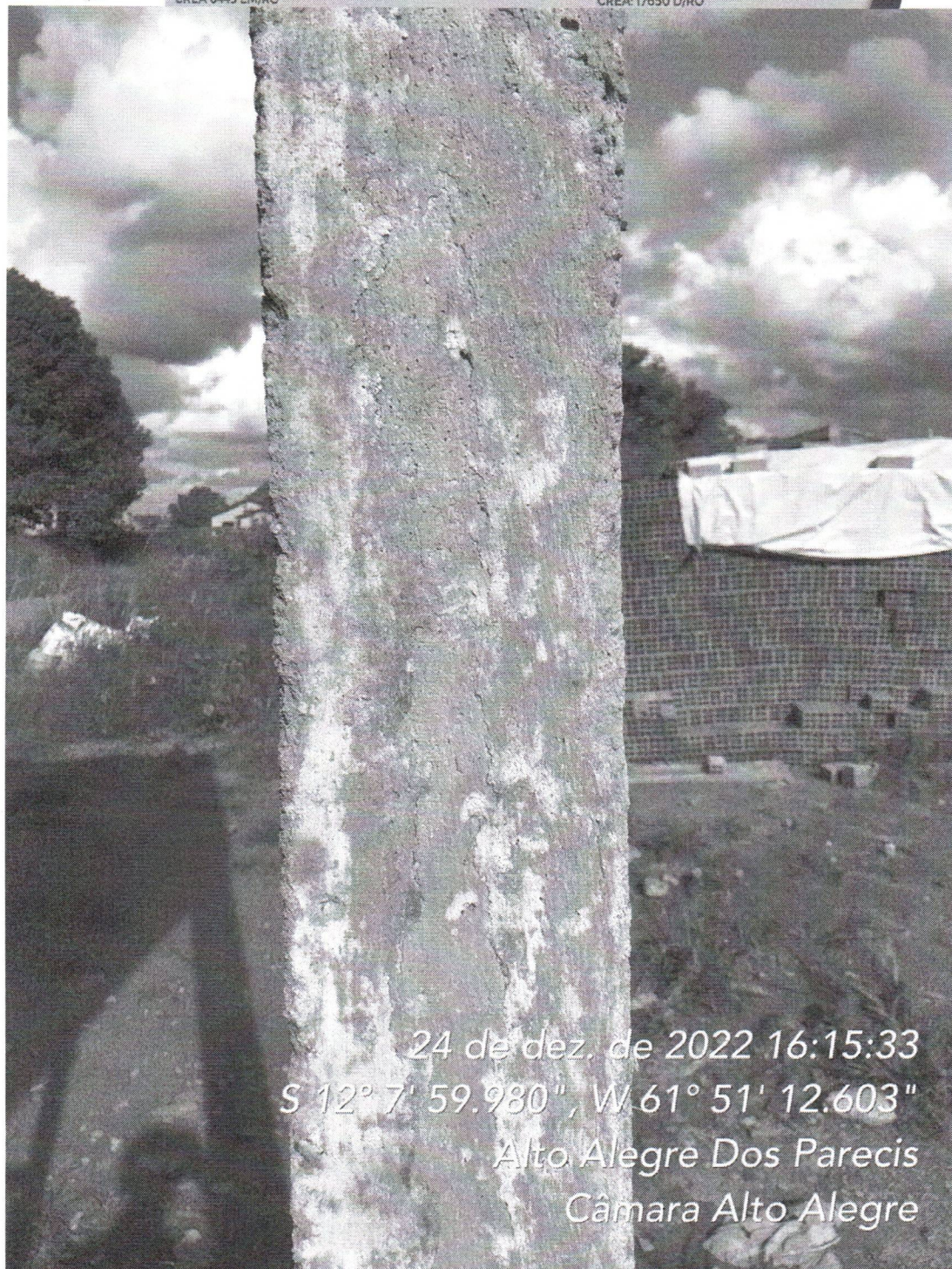
Figura 08 – Desagregação no eixo longitudinal do pilar P16.
